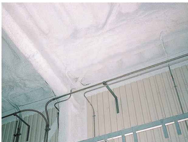
折板屋根／硬質ウレタン上の不燃コート（ダンセラボン #25）
